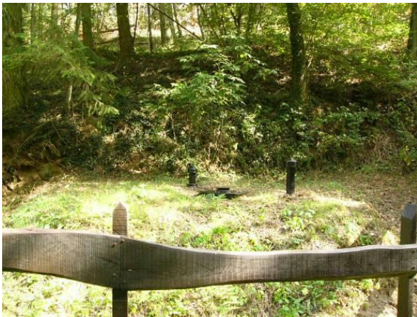
Photo 28 - Extérieur et intérieur du forage captage Supp
