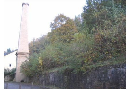
Photo 40 - Renforcement de talus constitué d'un mur et d'enrochements accompagnés de végétation arbustive au Sud du périmètre de Scherbaach
