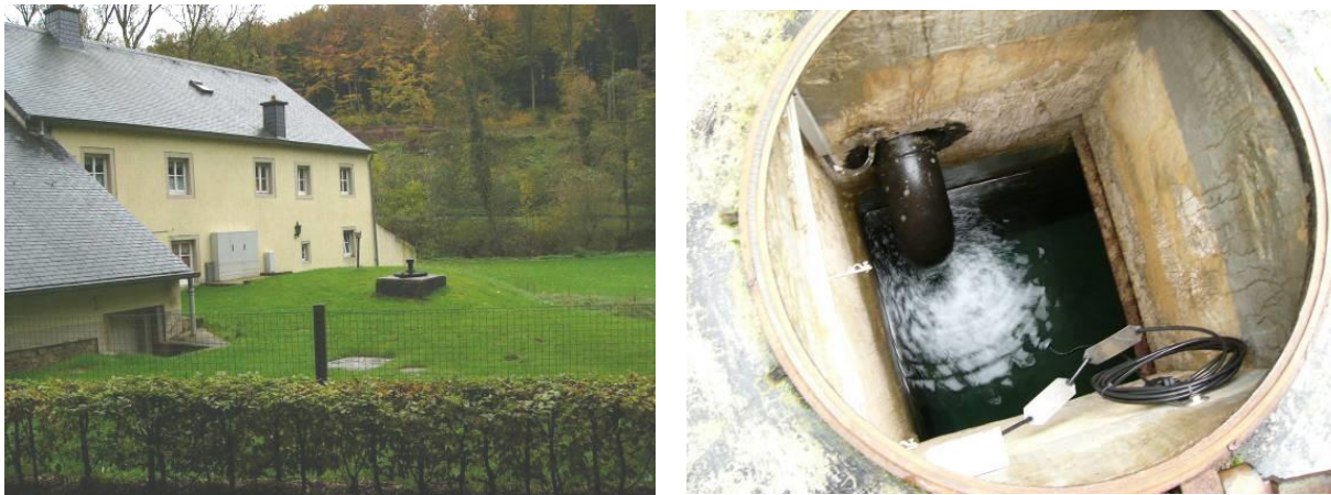
Photo 30 - Extérieur et intérieur du réservoir de la station de pompage
